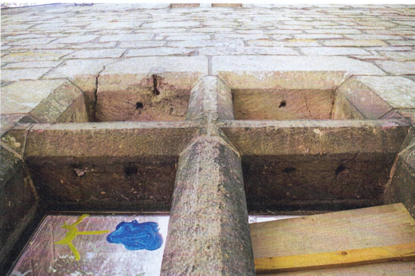
Bâtiment M - détail du barreaudage disparu de E.A.10. Remarquez les traces de compas qui indiquent le travail préparatoire à l'installation de l'aménagement.
